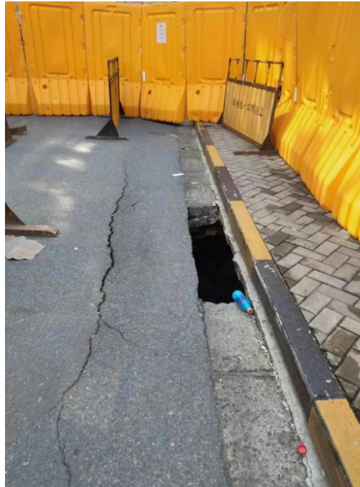
附件 1：镇坪路 81 弄路面沉陷照片
