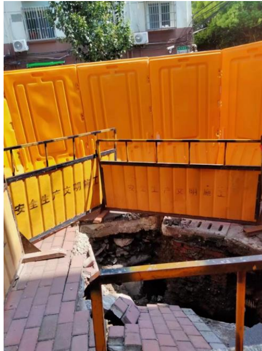
附件 2：镇坪路 79 弄路面沉陷照片
