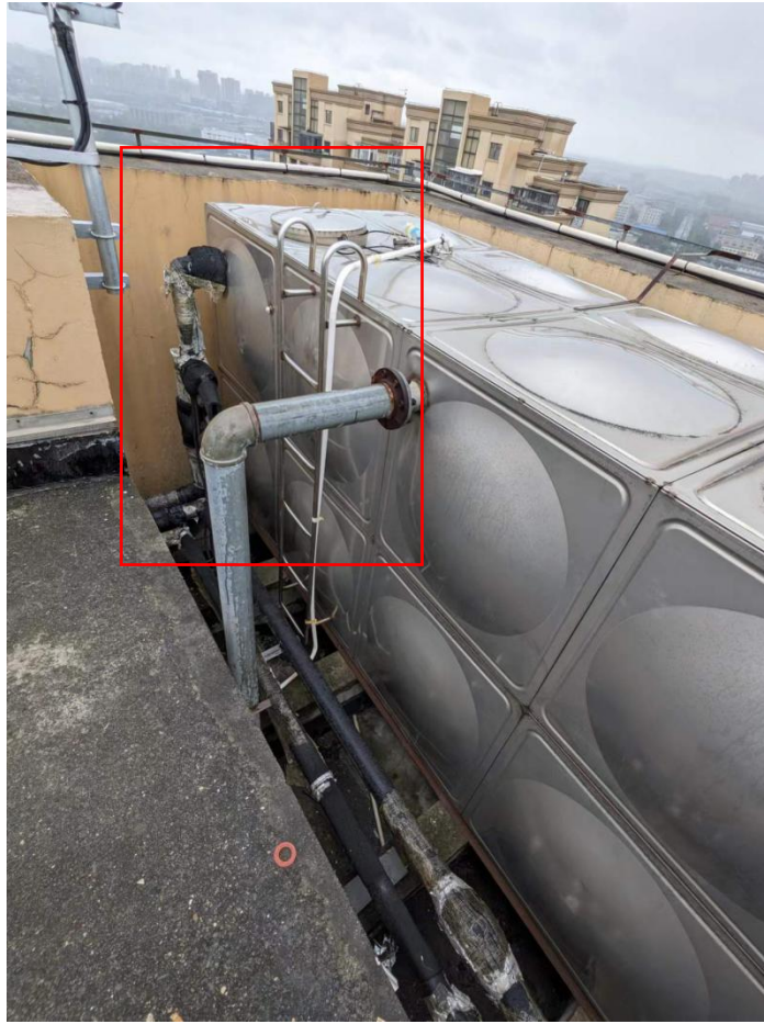
图 1 进水管道阀门与水箱竖梯
